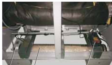
Система нейтрализации Система подъема конденсата Бустерный насос на поперечине
