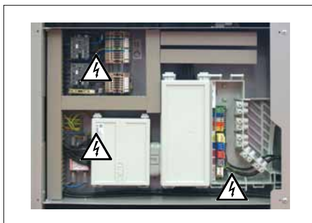
Коробки элементов управления Опасность поражения электрическим током
